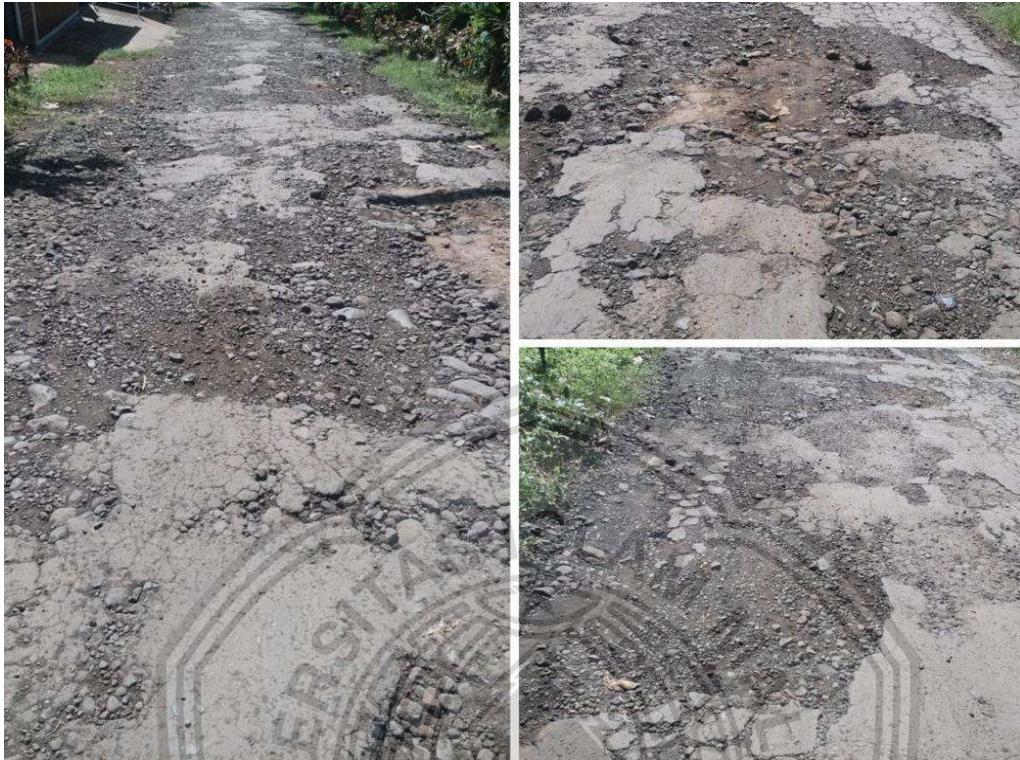
Gambar 1.1 Kondisi Jalan Lingkungan Suko Kelurahan Gombongsari
