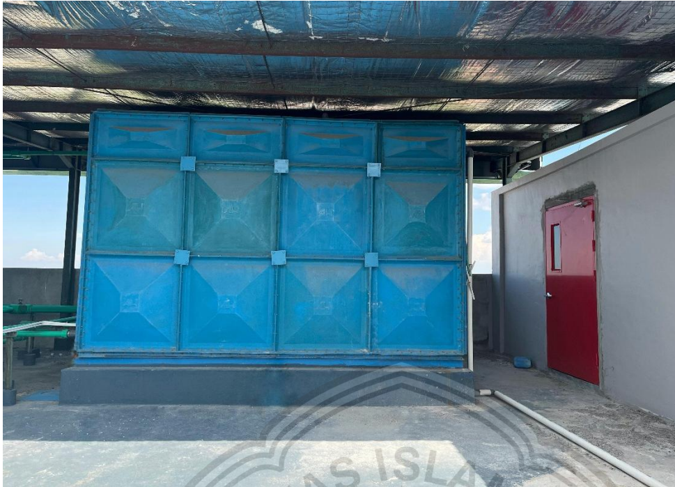
Gambar 3 Roof Tank Gedung RSUD Ibnu Sina Gresik Sumber : (Dokumentasi Pribadi, 2025)
